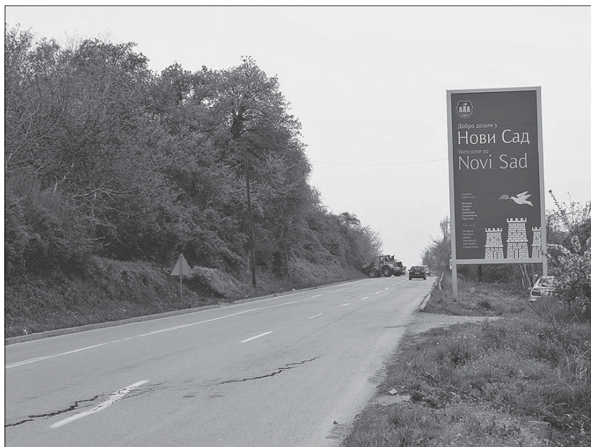
Прилог 1. Оштећење на регионалном путу Београд - Нови Сад услед клизања терена (20. април 2006.) - фото: М. Месарош
